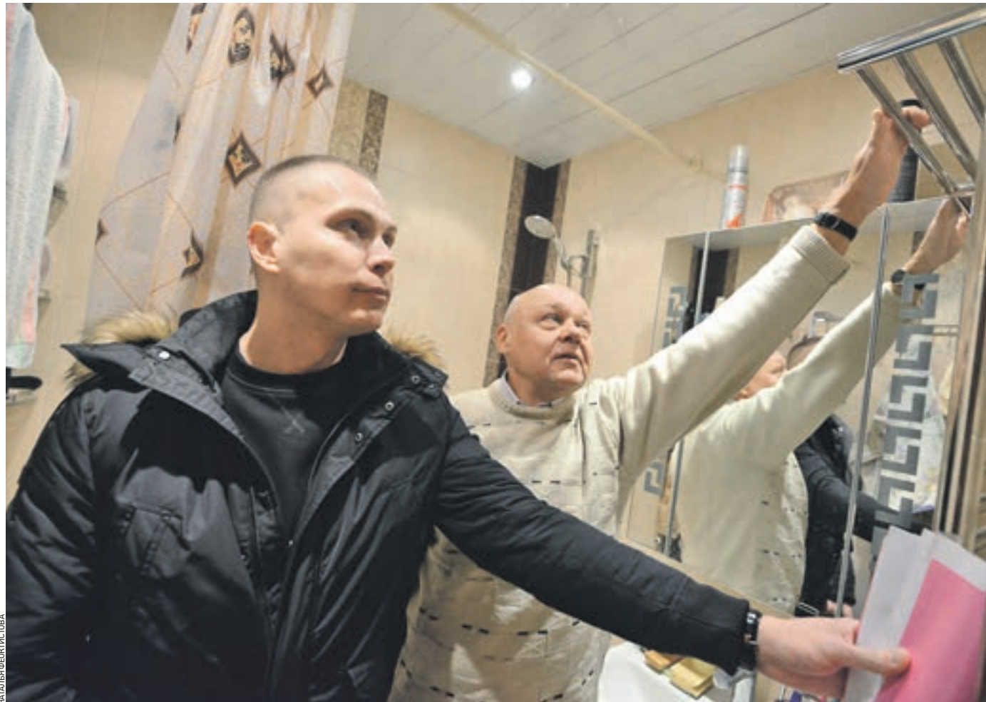
22 октября 13:20 Депутат Мещанского района Алексей Бондаренко (слева) и житель дома № 57, корпус 1, по Трифоновской улице Виктор Бакунин осматривают старые трубы холодного и горячего водоснабжения, которые не заменили в ходе капитального ремонта
