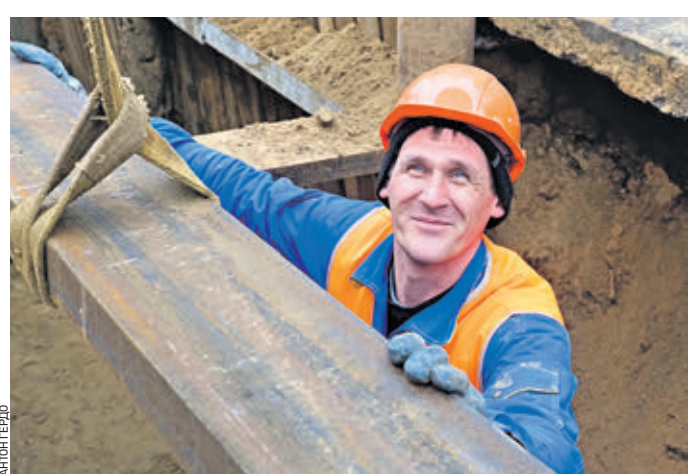
Вчера 11:19 Бригадир Роман Грецков проводит монтаж металлических креплений траншеи на Кирпичной улице
